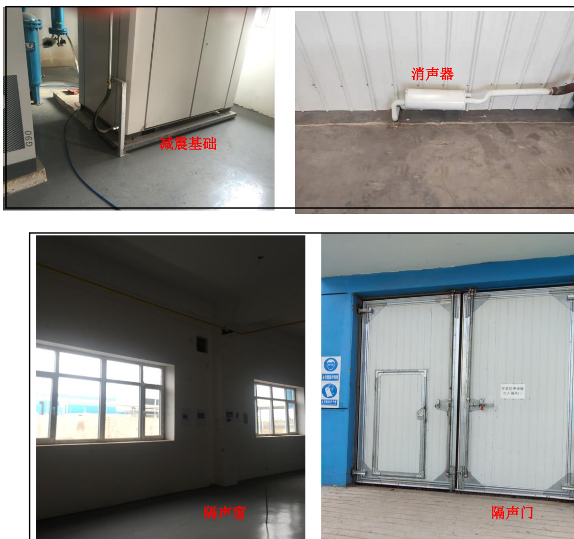
图 3.4-5 噪声治理设施现场图
