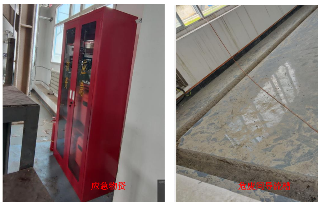
图 3.4-9 现有项目各风险防范设施现场图
