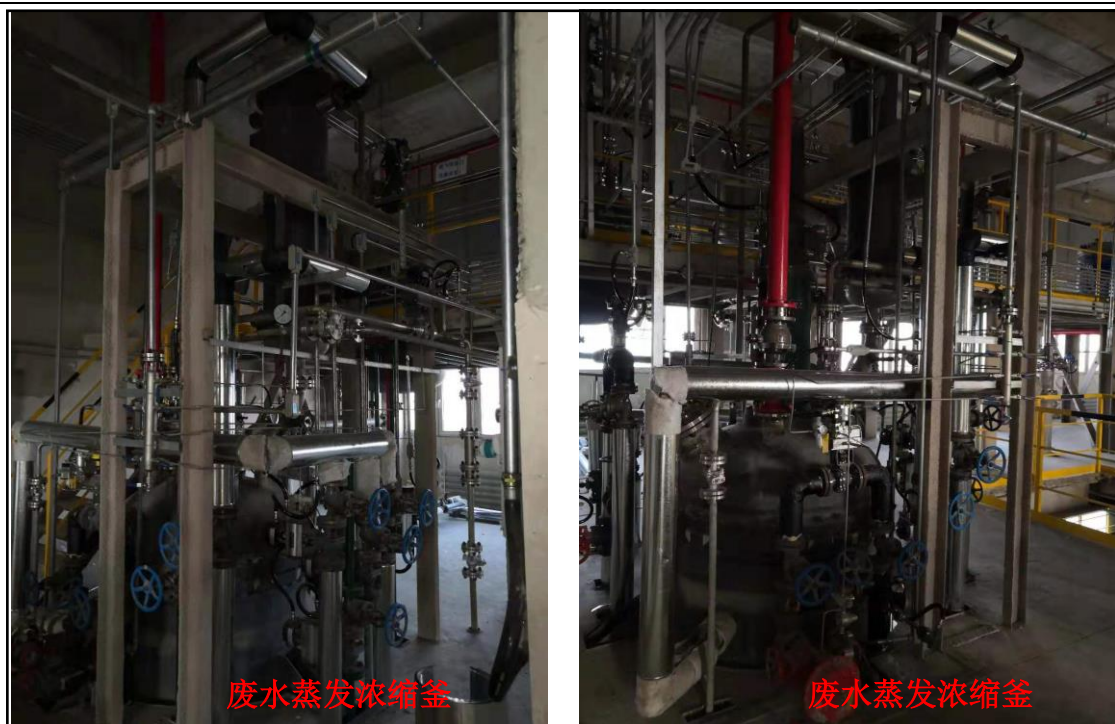
图 3.4-4 废水治理设施现场图片
