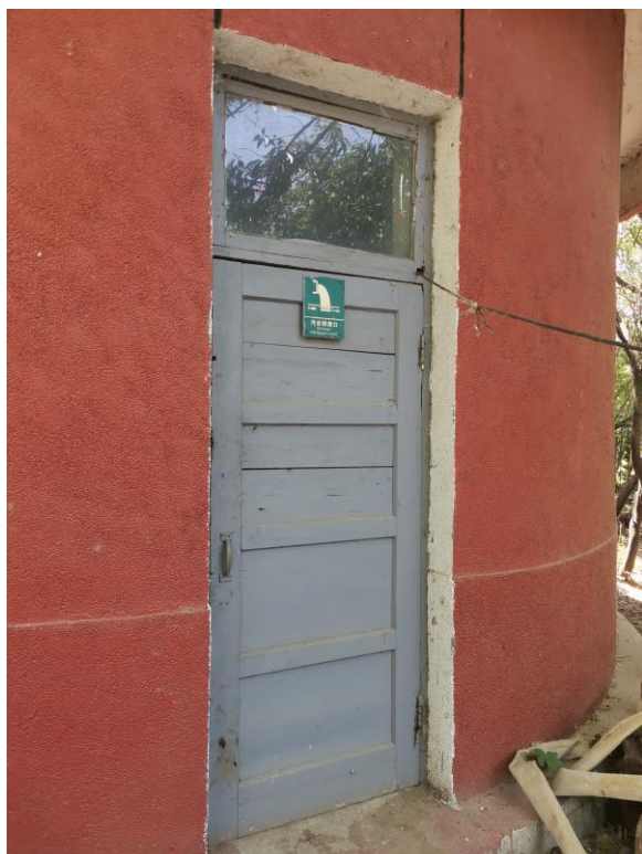
厂区污水总排口
